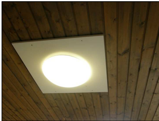
Abbildung 2: Deckenleuchte im Flur
