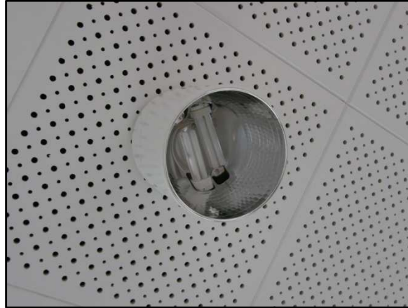
Abbildung 10: Energiesparlampe in der Küche im Gebäude Asse
