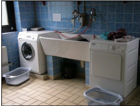
Abbildung 13: Waschmaschine und Trockner im Bestand im GebäudeASSE
