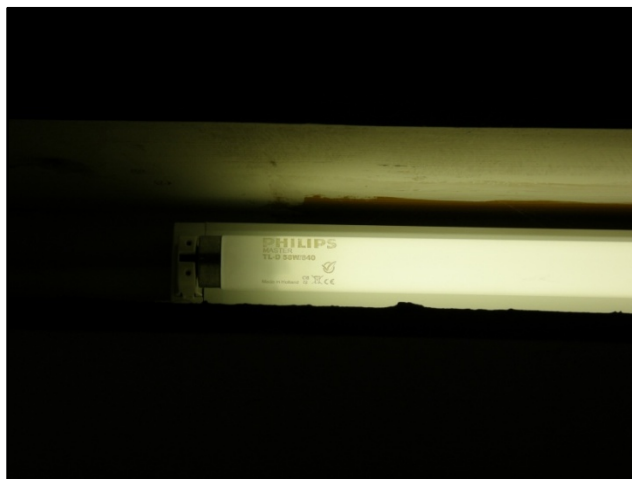
Abbildung 3: Leuchtstofflampe im Gebäude Asse
